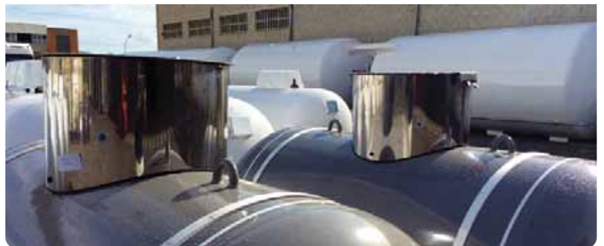
ARQUETAS DEPÓSITOS ENTERRADOS
